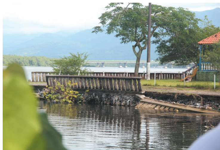
Muretas da Beira-Mar estão caindo...
